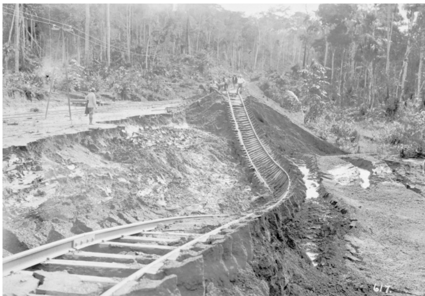
Deslizamiento de raíles provocado por las lluvias.
